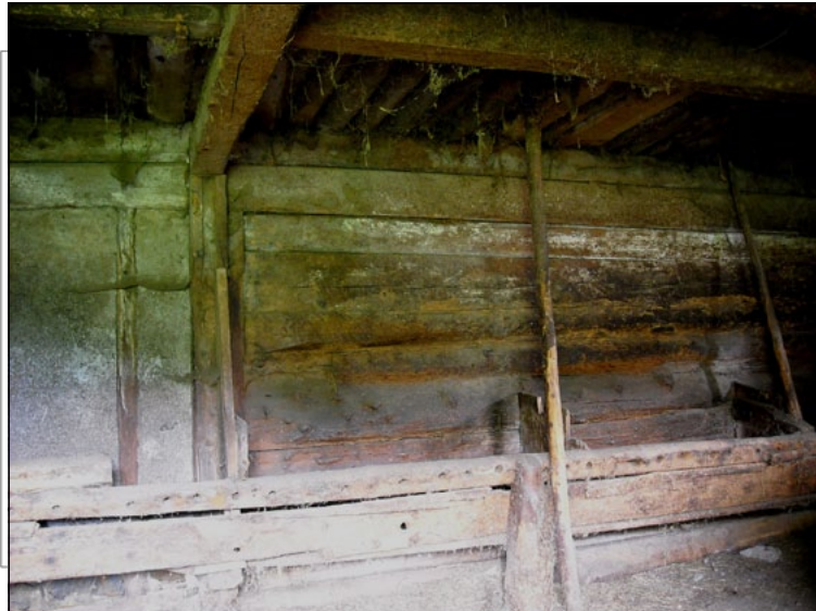
Punto di raccordo tra l'incastellatura della stalla (lato est) e la muratura a monte. Possibile tamponamento di un assetto che originariamente prevedeva una porta per la stalla anche sul lato est.
