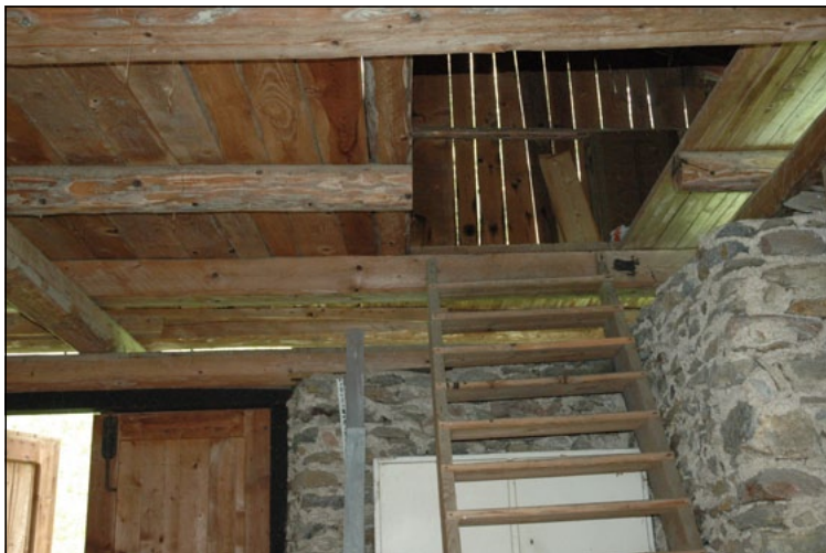
Interruzione del solaio per il passaggio della scala con trave apparentemente a sbalzo ed invece sostenuta dalla trave di bordo all'estradosso del solaio all'estremità dell'aggetto.
