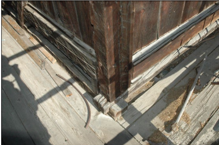
Nodo tra la colonna d'angolo e il telaio all'estradosso del primo solaio. Tamponamento dei vani del telaio con tavole verticali bloccate sulle teste con listello e contro listello chiodato alle travi.
