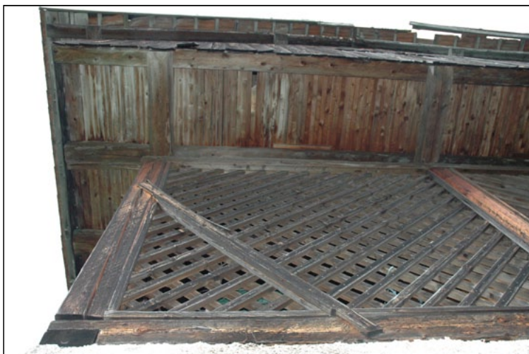
Lati aperti del fienile al secondo livello tamponati con graticcio di listelli.
