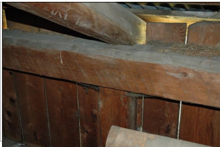
Tacca di adattamento sui correnti di copertura per facilitare il punto d'appoggio chiodato e per eliminare la possibilità di scivolamento.
