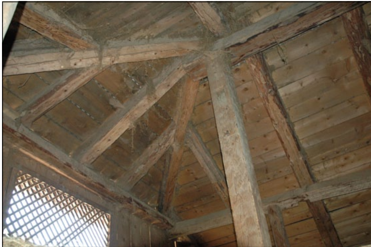
Colona a sostegno dell'estremità della trave di colmo su cui convergono i correnti di displuvio dello smusso.
