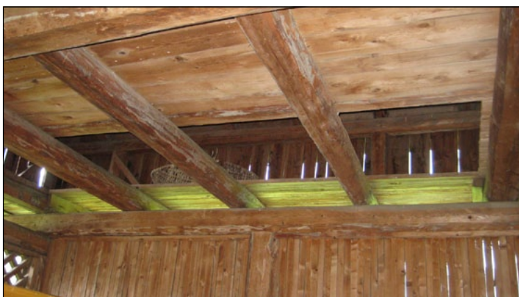
Le aperture nel pavimento al terzo livello favoriscono lo stivaggio del fieno al secondo livello introdotto per caduta, facilitando il riempimento fino all'intradosso del solaio, che risulterebbe manualmente difficile operando dal piano inferiore.
