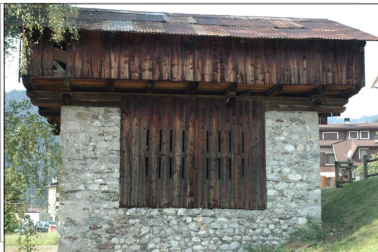
Asole nel tavolato di tamponamento tra i setti murari per favorire la ventilazione.
