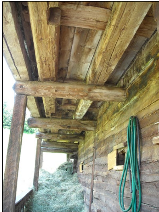
Incastellatura chiusa sulla parete a valle della stalla al 2° livello d'uso. Vista sul ballatoio con le mensole reggi ballatoio quali estremità a sbalzo delle travi del solaio. Piancito del ballatoio irrobustito oltre che dalla trave di bordo, da due travi intermedie.
