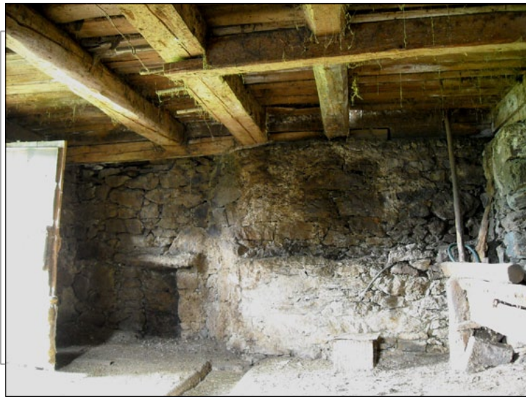
Perdita della continuità della controcatena sul limite dell'aia del piano soprastante.
