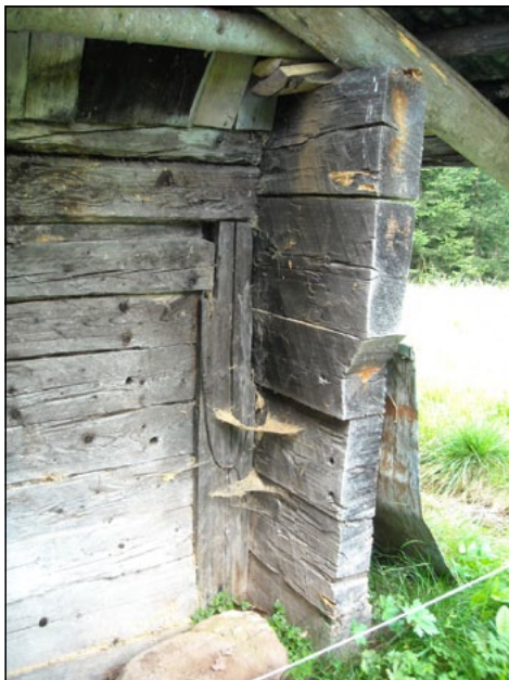
Connessione tra la parete divisoria (già interna) e la parete d'ambito esterna sul retro. Le travi di incastellatura di questa parete si sviluppano in continuità fino all'ammorsatura d'angolo esterna a monte. Nello stato di fatto la situazione regolarizzata dopo i lavori di parziale ripristino.
