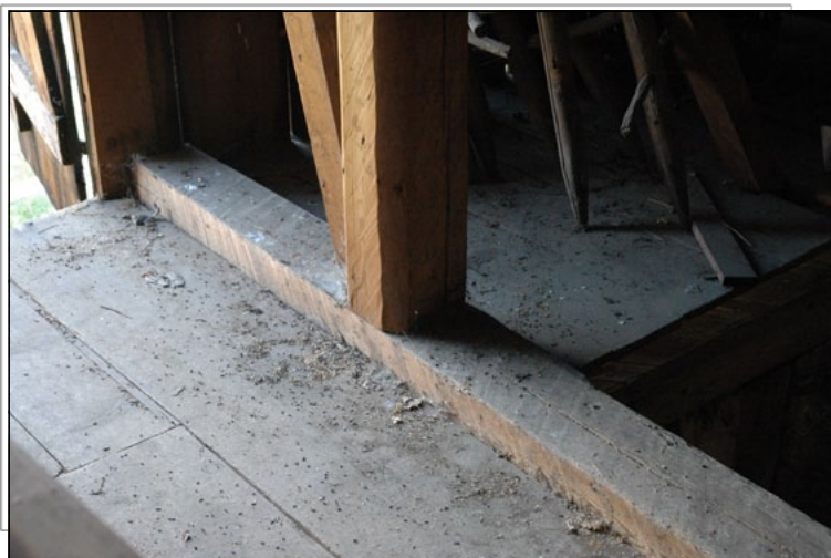
Le colonne della trave di colmo poggiano su una trave ripartitrice sovrapposta al solaio e parallela alla trave rompitratta d'impalcato mediana.
