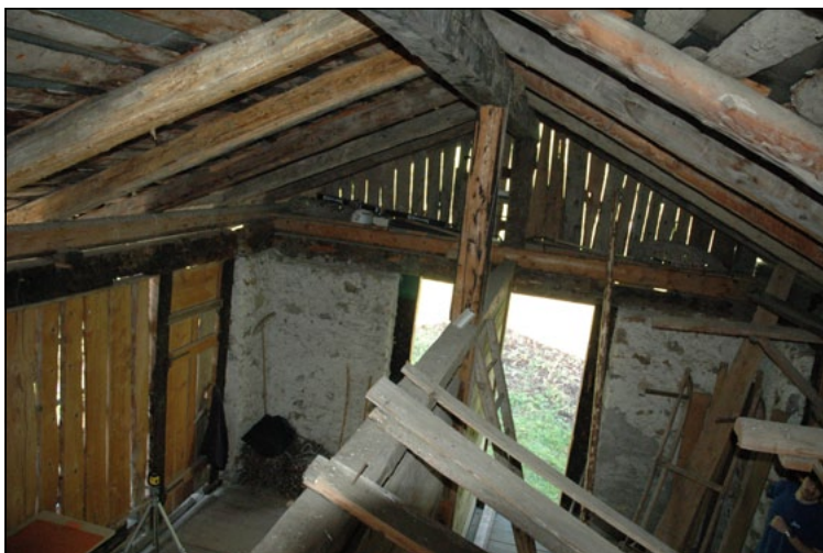
L'aggetto a monte (visto dall'interno) determina un piccolo soppalco usato come ripostiglio.
