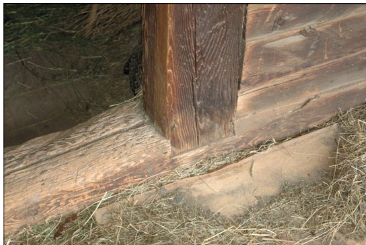
Ammorsamento del ritto/stipite sulla porta del ballatoio, incastrato alla cordolatura di base. Sul punto il ritto svolge anche la funzione di fermo per l'incastellatura chiusa a monte.
