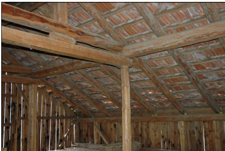
Trave di colmo e terzere scaricano su colonne allineate alle strutture perimetrali e su una trave di solaio a sezione maggiorata.
