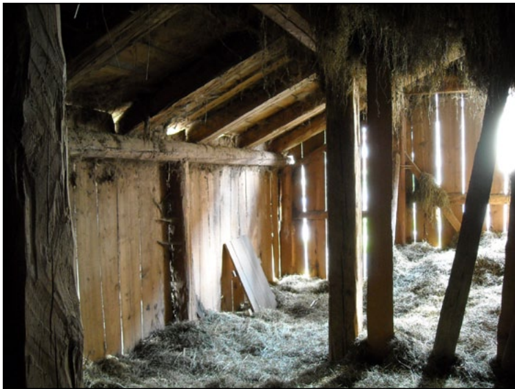
Trave di gronda e colonne esterne sulla linea del profilo esterno del ballatoio.
