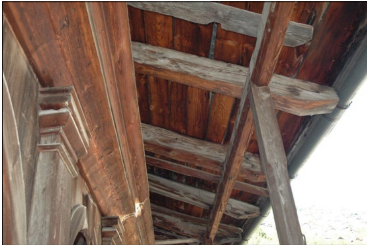
Sul profilo esterno della balconata, dalla trave di bordo si ergono i ritti fin contro la trave di gronda ancorata all'estremità dei correnti.
