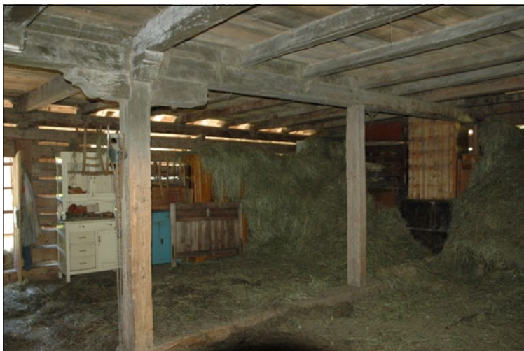
Telaio strutturale interno con trave rompitratta e colonne di scarico su trave ripartitrice alla quota del solaio del 3° livello.
