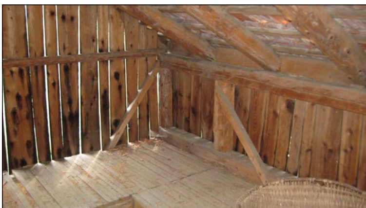
Angolo tra timpano e telaio di bordo / gronda con saette di controventatura.
