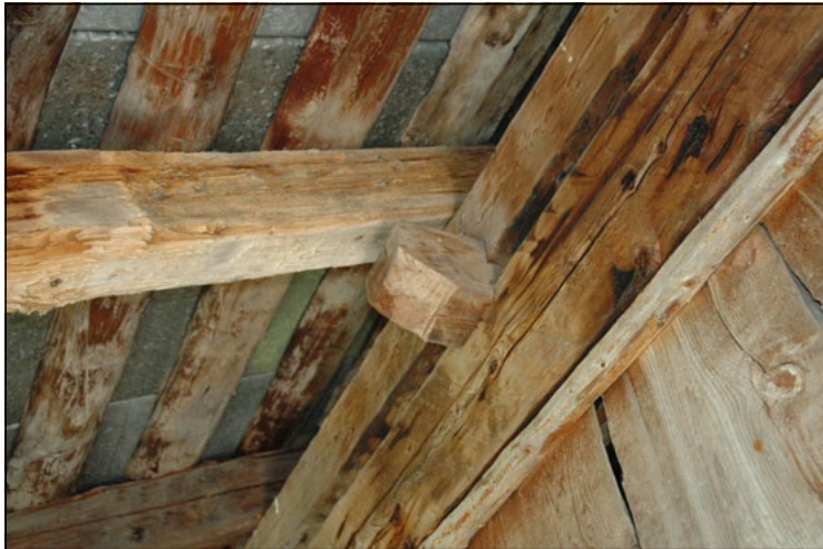
Spina di distanziamento e bloccaggio dei movimenti reciproci tra le travi ammorzata sulla cordolatura perimetrale.
