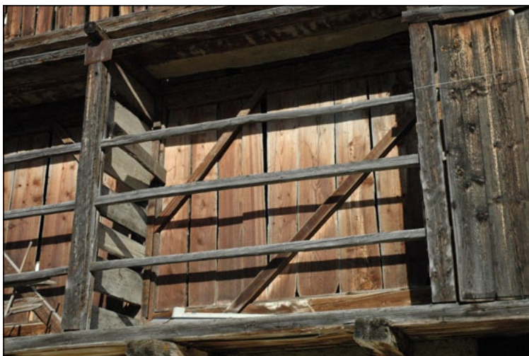
Parapetto del ballatoio con tavolato a protezione del lato esposto e stanghe incastrate al ritto centrale a sua volta ammortato alla cordolatura centrale sull'uscita a sbalzo della trave di sottocolmo.
